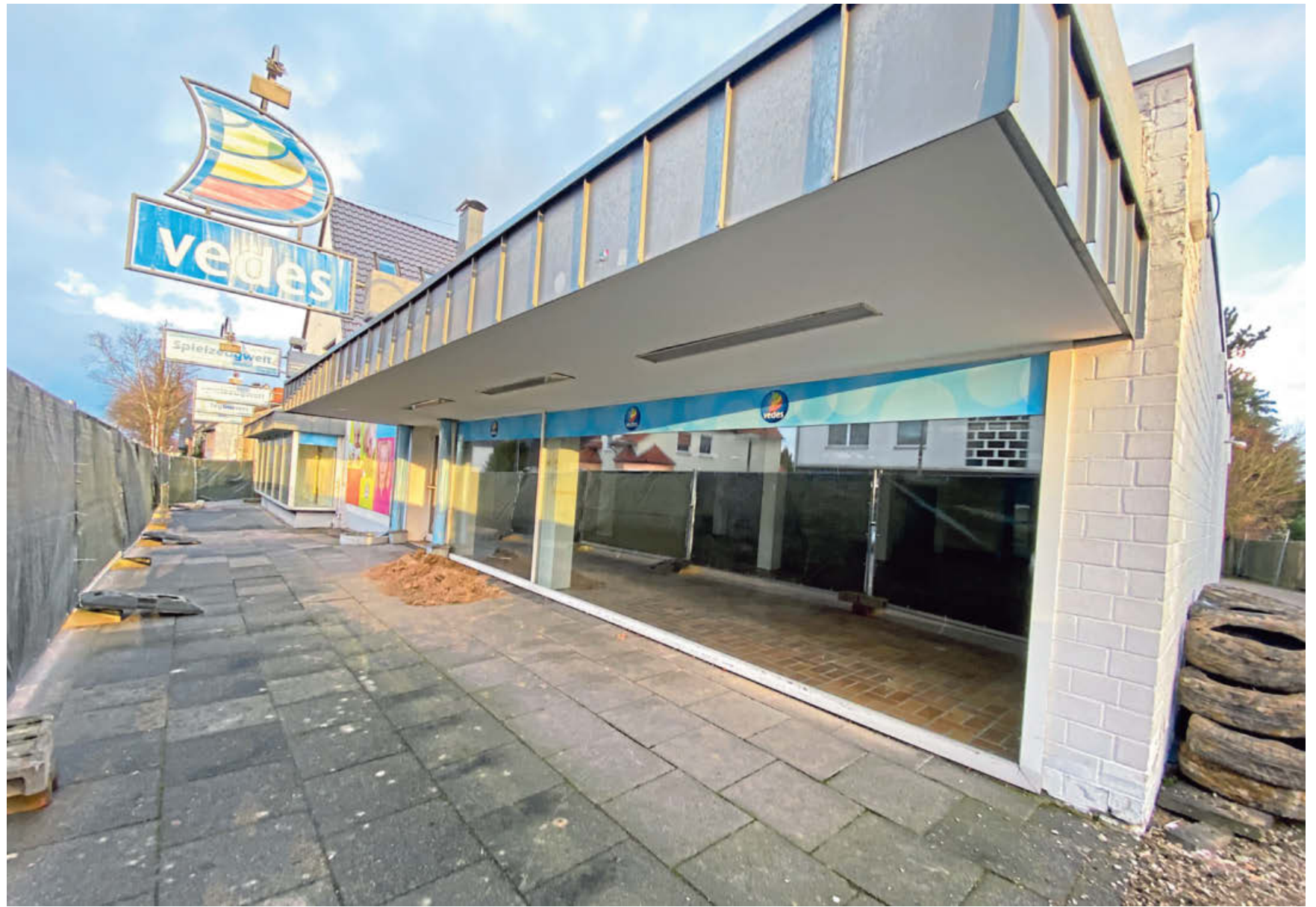
Mehr als 60 Jahre lang wurden bei Tegtmeyer Spielwaren verkauft. Jetzt wird das Gebäude abgerissen.
