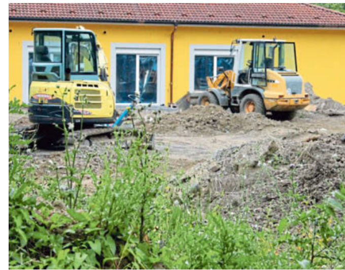
Im künftigen Garten der Einrichtung sind noch die Bagger am Werke. Bald wird ein schöner Aufenthaltsbereich im Freien entstehen.
