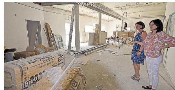
Im Erdgeschoss läuft noch der Innenausbau des Gemeinschaftsbereichs von „Haus Konstantin“. Schlüsselübergabe ist am 31. Juli.
