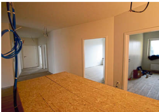
Noch dominieren die Handwerker, doch schon bald soll in der ersten Etage die Hausarzt-Praxis von Ute Kryz einziehen.
